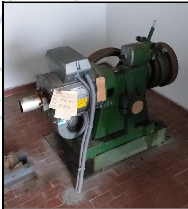
Argano dell'ascensore posto al terzo piano dell'ITCG Cerboni
